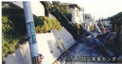
① 震災で崩れた壁
