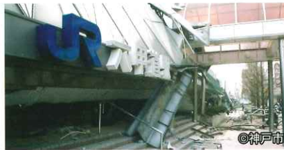
① 崩壊しているJR六甲道駅
