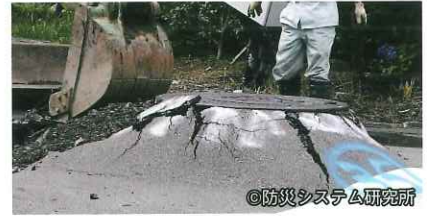
① 盛り上がるマンホール
