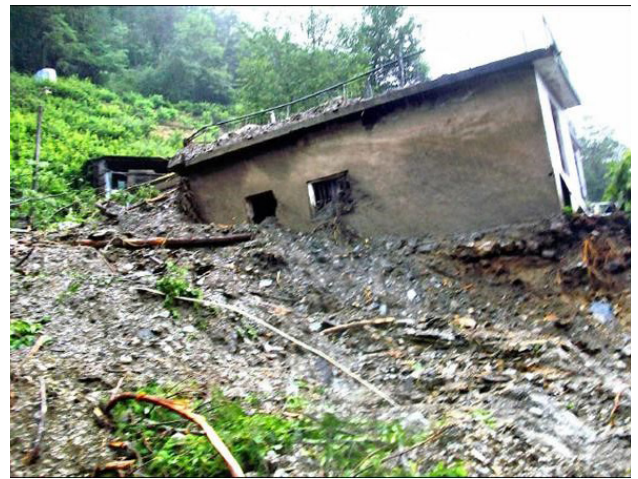
圖 5-6 梨山佳陽分站邊坡崩塌
