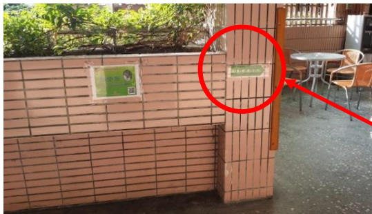
走廊交叉處 避難疏散指標
