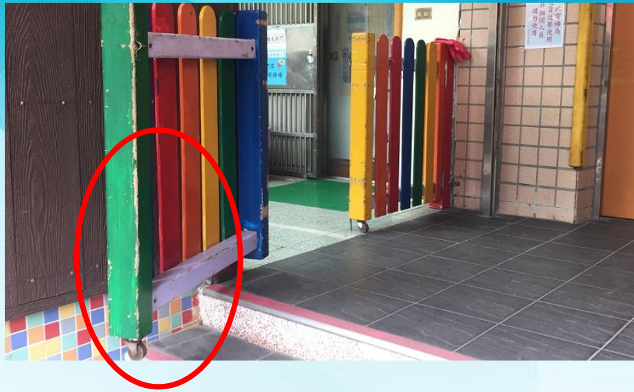
階梯前的欄柵 (危險)
