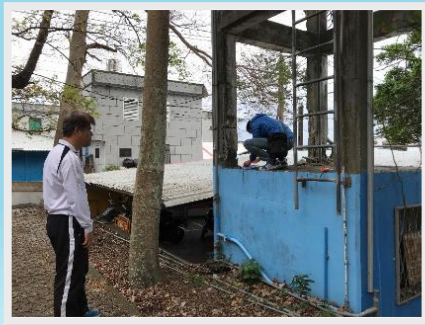
水塔鋼筋裸露
