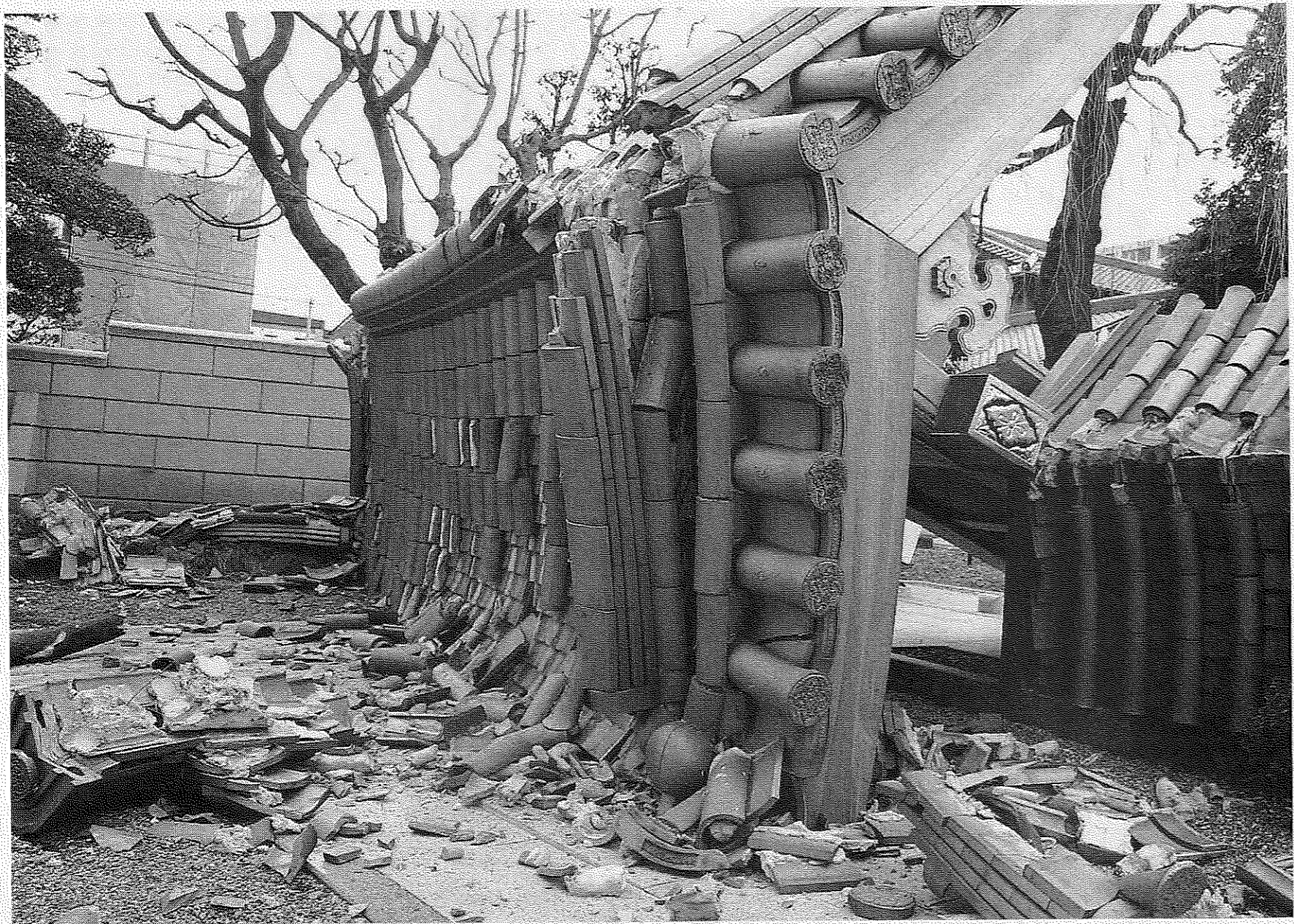
壁と門扉が崩れ、瓦が散乱した寺院=11日午後3時50分ごろ、仙台市宮城野区
