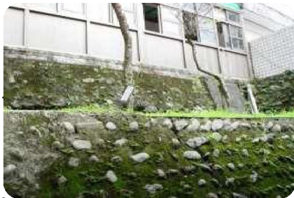
校舍下方龜裂情形嚴重
